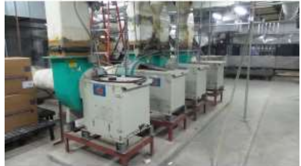
BROD031e 4/19/2016 Abandoned fume hood fans 1E, 2E, 3E, and 4E Room 8N08
