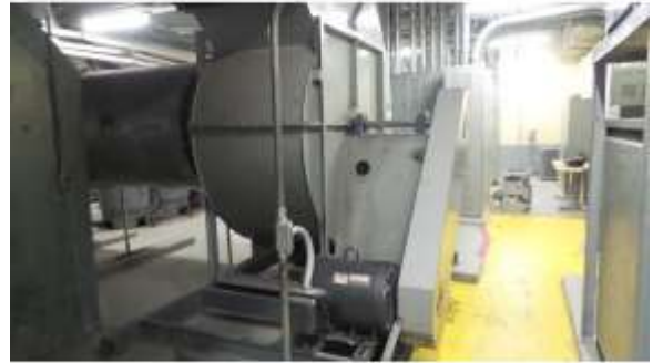
BROD064e 4/19/2016 Air handler AC2 return fan Room GW58
