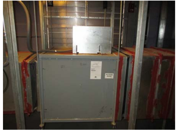
255013e 5/11/2021 5 hp exhaust fan EF-4 East penthouse
