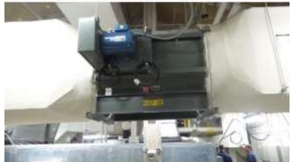
AHSB005e 4/20/2016 Inline return air fan RAF-3E East penthouse
