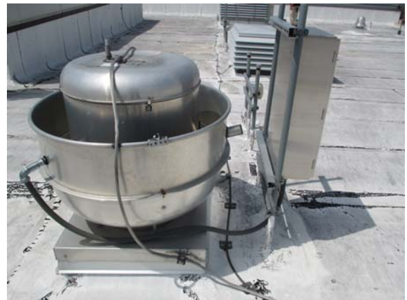
256009e 5/11/2021 1.5 hp exhaust fan (EX-6) Roof
