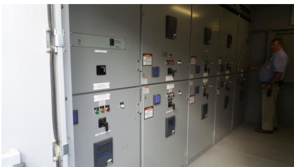
HSEL005e 4/21/2016 POD #1 switchgear GUC POD #1
