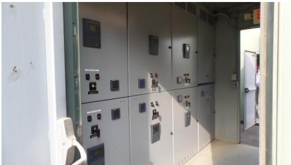
HSEL003e 4/21/2016 POD #2 switchgear GUC POD #2
