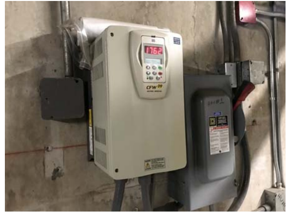
AUST028e 5/11/2021 VFD for AHU-001 Room 149
