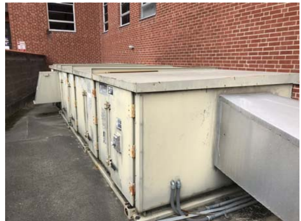
AUST021e 5/11/2021 Air handling unit AHU-004 Site
