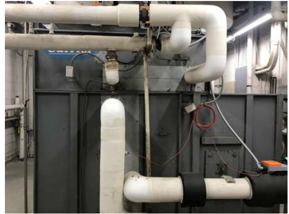
AUST017e 5/11/2021 Air handling unit AHU-002 Room 144
