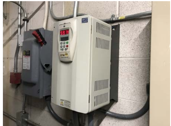
AUST018e 5/11/2021 VFD for AHU-002 Room 144
