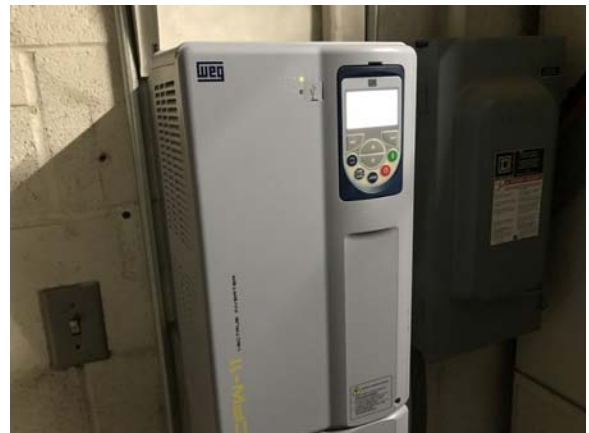
AUST015e 5/11/2021 VFD for AHU-003 Room 237
