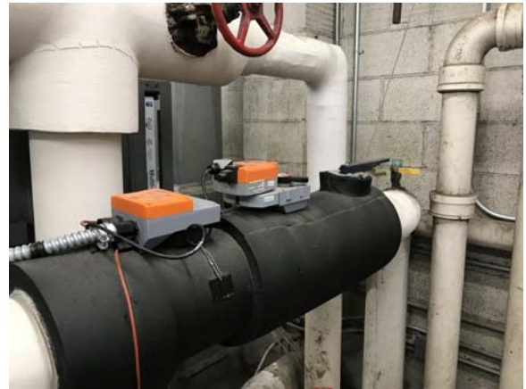
AUST014e 5/11/2021 DDC valve positioners Room 237
