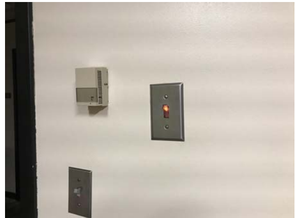
BATE011e 5/11/2021 Local thermostat Room 3015
