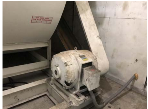
BATE029e 5/11/2021 Return fan for AHU-001 Room 1040A
