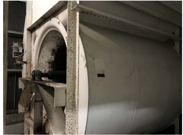
BATE028e 5/11/2021 Supply fan for AHU-001 Room 1040A
