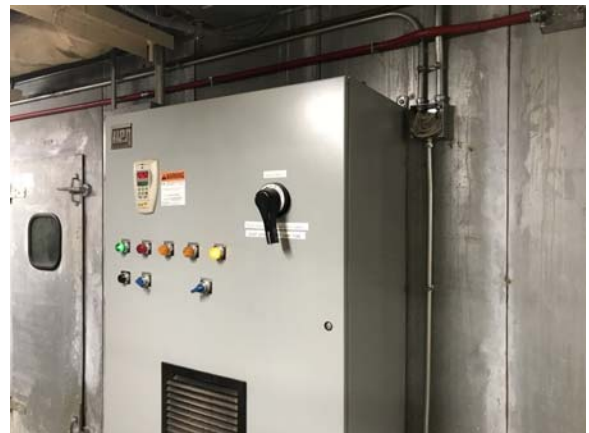
BATE027e 5/11/2021 VFD for supply fan for AHU-001 Room 1040A
