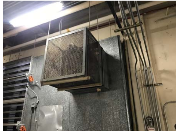
BATE019e 5/11/2021 Propeller-style exhaust fan Room 1040A
