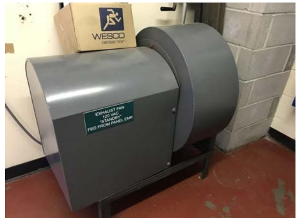
BATE042e 5/11/2021 Utility-style exhaust fan Room 1036
