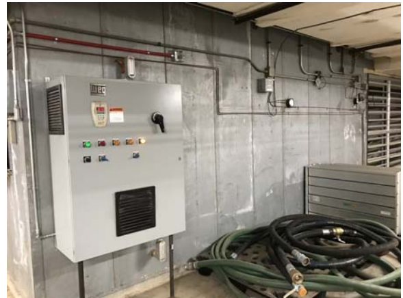
BATE026e 5/11/2021 VFD for return fan for AHU-001 Room 1040A
