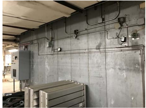
BATE025e 5/11/2021 Air handling unit AHU-001 Room 1040A
