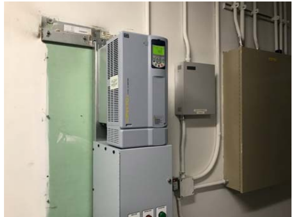
RIVW008e 5/12/2021 VFD for AHU-002 supply fan Room RW-222
