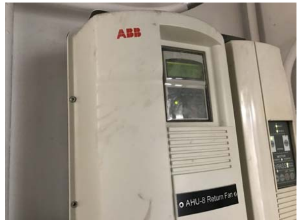
RIVW027e 5/12/2021 VFD for AHU-001 return fan Room RW-118
