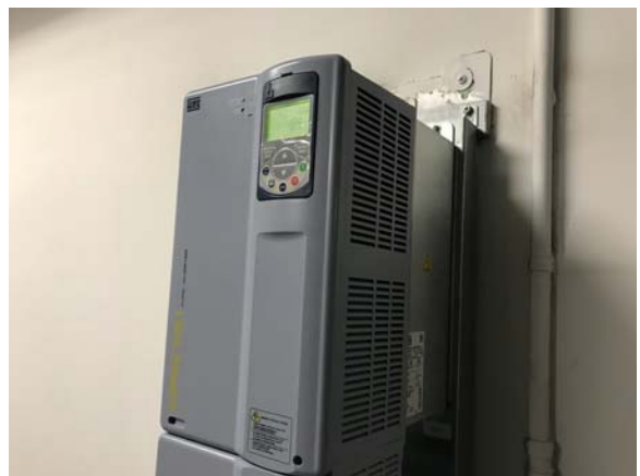
RIVW009e 5/12/2021 VFD for AHU-002 return fan Room RW-222
