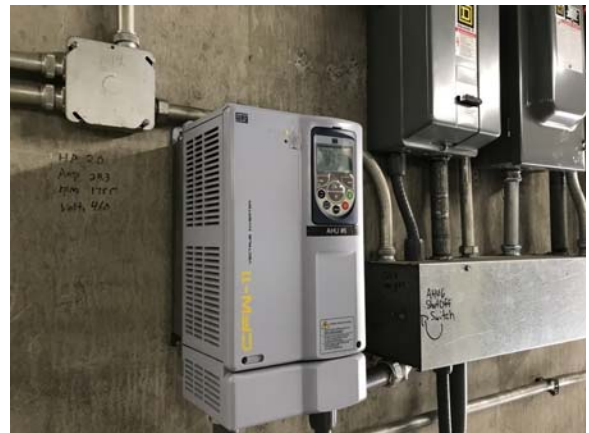
RIVE057e 5/13/2021 VFD for AHU-006 Room 04
