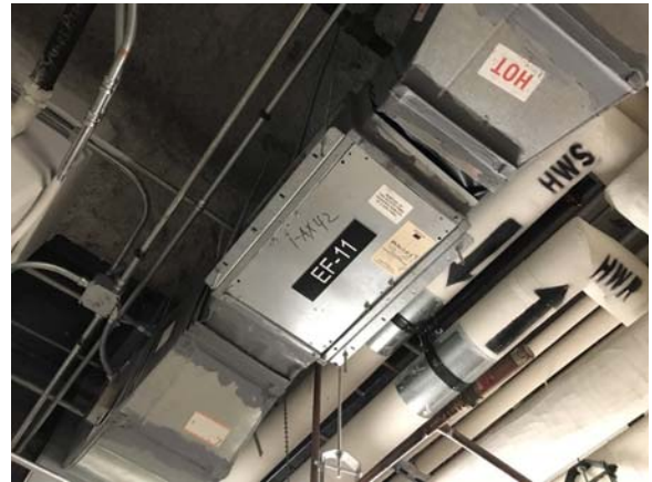
SCIT065e 5/10/2021 Inline exhaust fan Room C101
