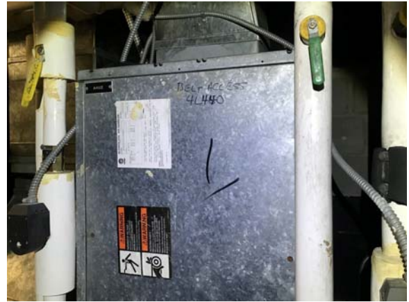
SLAY016e 5/12/2021 Fan coil unit Room 152
