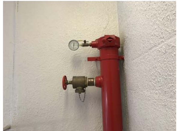
SLAY008e 5/12/2021 Fire suppression stand pipe Stairwell
