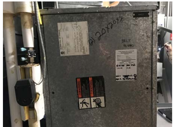
SLAY015e 5/12/2021 Fan coil unit Room 152
