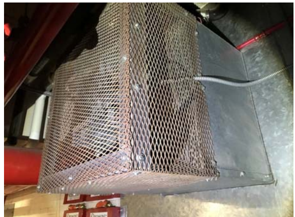
UMST018e 5/12/2021 Propeller exhaust fan Room 002
