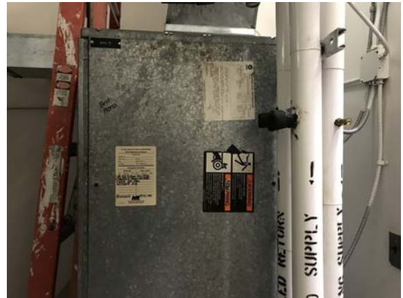
UMST035e 5/12/2021 Fan coil unit Room 167
