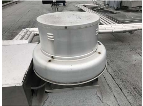
UMST004e 5/12/2021 Centrifugal rooftop exhaust fan Roof
