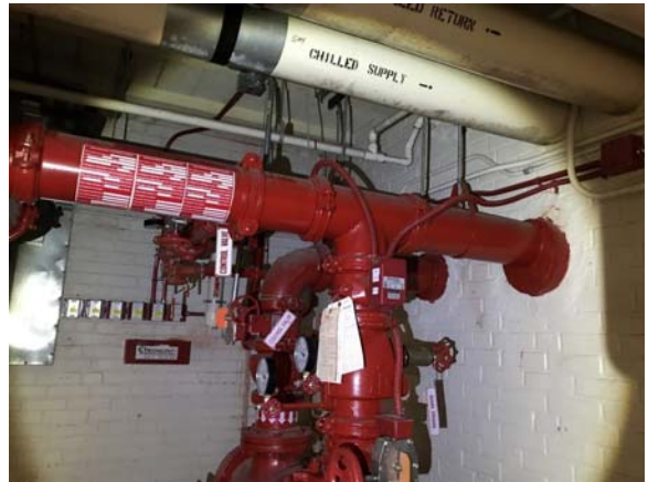
UMST017e 5/12/2021 Fire suppression riser piping Room 002
