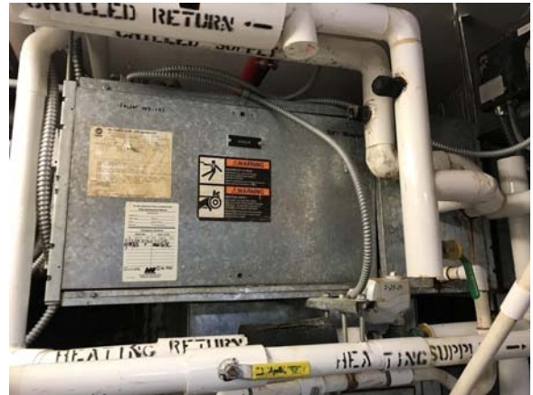
UMST032e 5/12/2021 Fan coil unit Room 164
