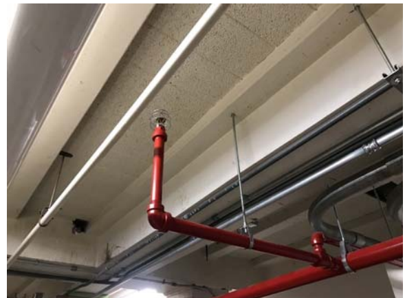
UMST015e 5/12/2021 Fire suppression sprinkling device Room 006
