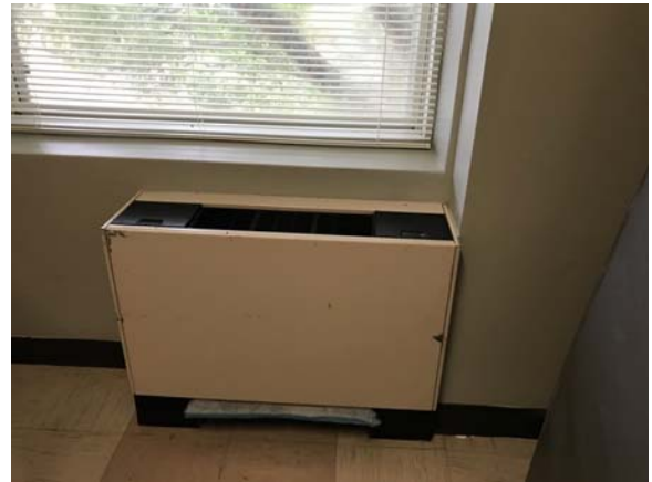
UMST011e 5/12/2021 Console fan coil unit Room 305
