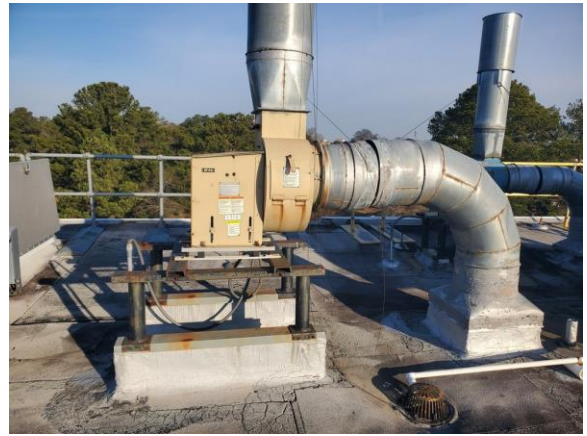
013001e 1/11/2023 Utility set fan EF-3-2 for fume hood Roof
