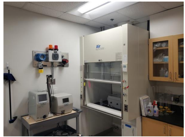
013029e 1/11/2023 Fume hood Room 3501
