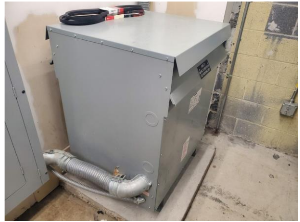
013014e 1/11/2023 Siemens dry type transformer Room 3303
