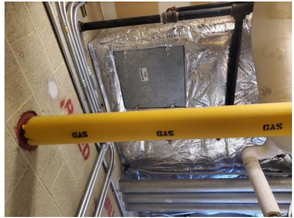
013043e 1/11/2023 Natural gas pipe Room 1306
