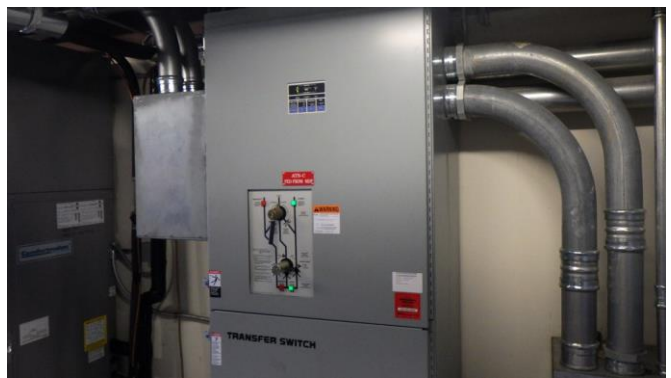
164045e 1/25/2023 Emergency power ATS-C Electrical 137
