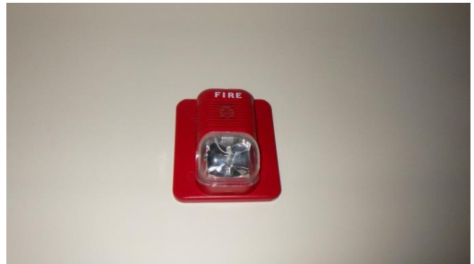
164005e 1/25/2023 Horn/strobe Lobby 0101
