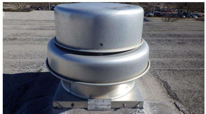
164012e 1/25/2023 Roof exhauster EF-3 Roof
