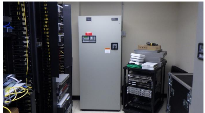
164027e 1/25/2023 CRAC unit 21 Telecom 145
