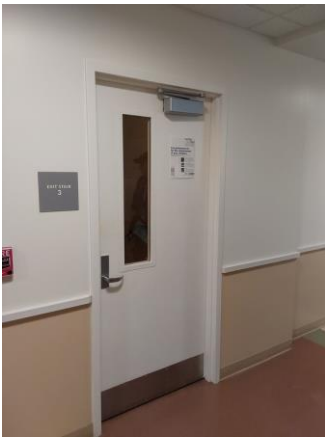
002024a 1/9/2023 Noncompliant door hardware Stair 3
