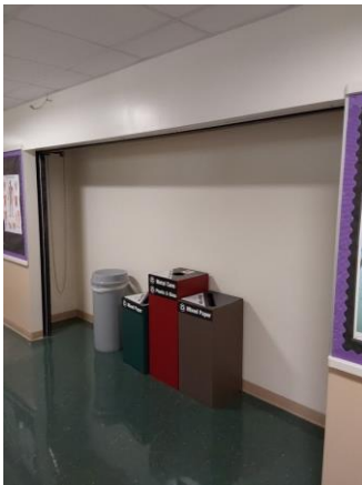
002060a 1/9/2023 Roll-up fire door Room 3202
