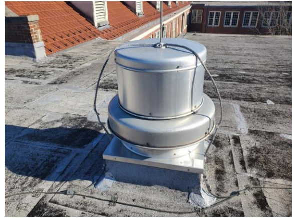
002001e 1/9/2023 Rooftop exhaust fan EF-2 Roof
