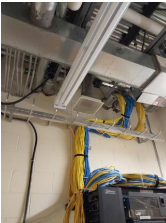
009060a 1/10/2023 Conduits missing fire stop Room OB112
