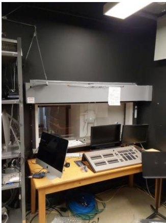
009069a 1/10/2023 Projector roll-up fire door Room OC206
