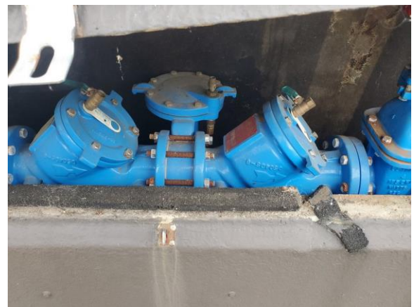
009075e 1/10/2023 Main backflow preventer Site
