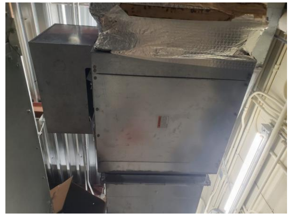
009021e 1/10/2023 AHU-5 return fan Mechanical B135
