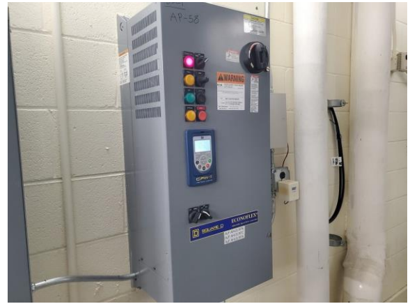
009020e 1/10/2023 AHU-5 return fan VFD Mechanical B135
