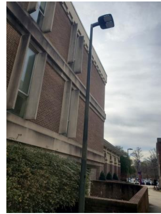
009073e 1/10/2023 Pole-mounted light fixture Site
