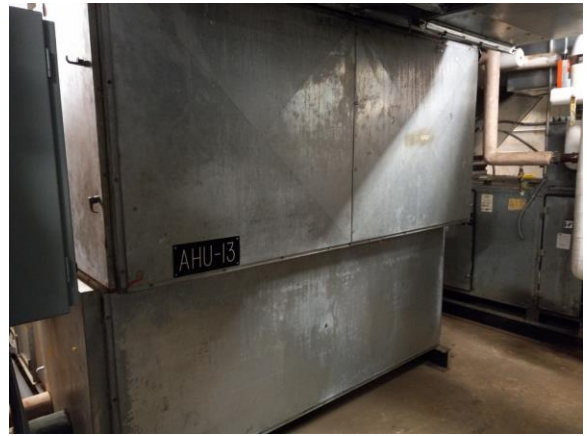
001A010e 1/12/2023 Air handler AHU-13 Room B01
