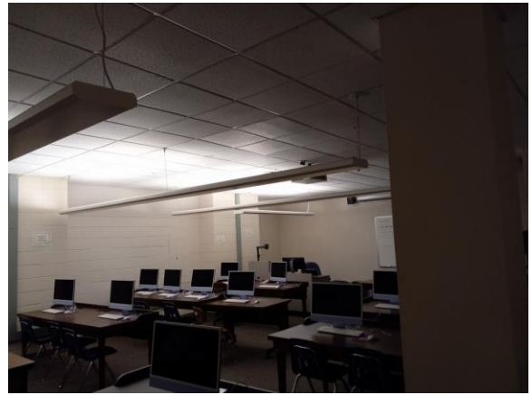
001A052e 1/12/2023 Pendant style interior lighting Room 118
