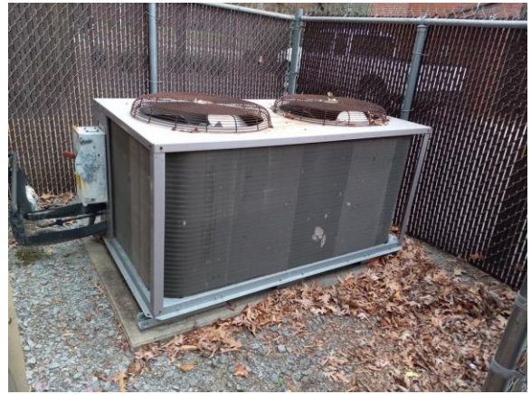
001A056e 1/12/2023 15 ton air cooled condenser Site
