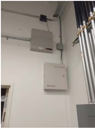
001014a 1/12/2023 Door control boxes Room 4900
