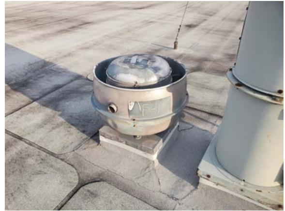
001001e 1/12/2023 Rooftop exhaust fan Roof
