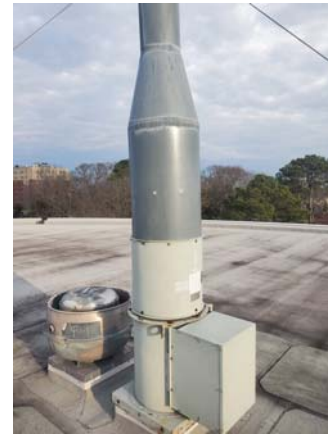
001002e 1/12/2023 Utility set fan Roof
