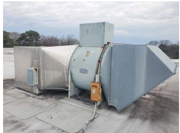
001003e 1/12/2023 Inline fan EF-1 Roof
