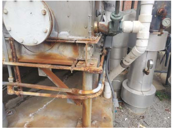
001121e 1/12/2023 Corrosion on tower structure and conduit Site
