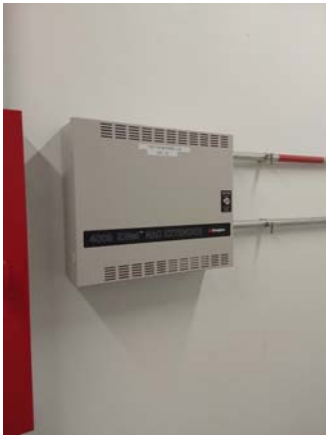
001065a 1/12/2023 Door control box Room 2908
