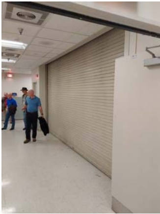
001077a 1/12/2023 Overhead coiling door Room 1080
