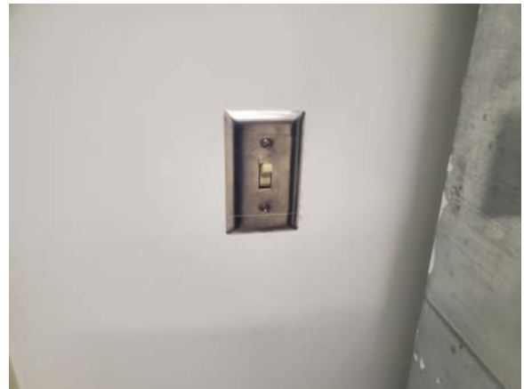
001009e 1/12/2023 Typical light switch Data 4901
