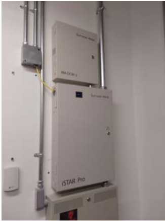
001061a 1/12/2023 Door control box Room 2905
