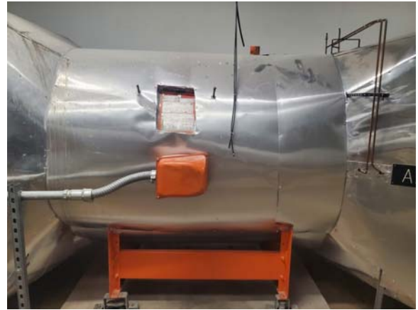
001094e 1/12/2023 Return air fan for BUAS Mechanical B901
