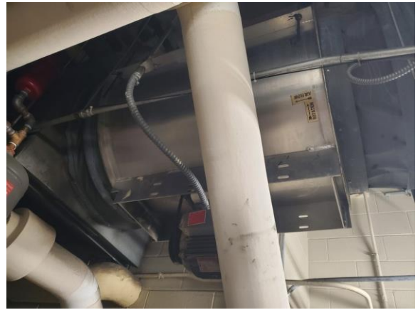
033053e 1/10/2023 Air handler return fan Mechanical 126
