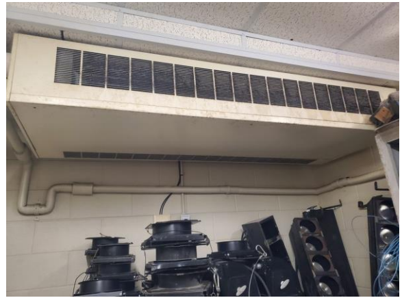
033005e 1/10/2023 Fan coil F-3 Dimmer room 214
