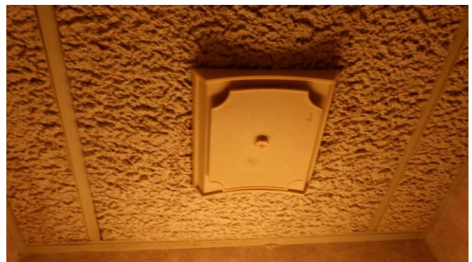
118015e 1/26/2023 Exhaust fan Restroom
