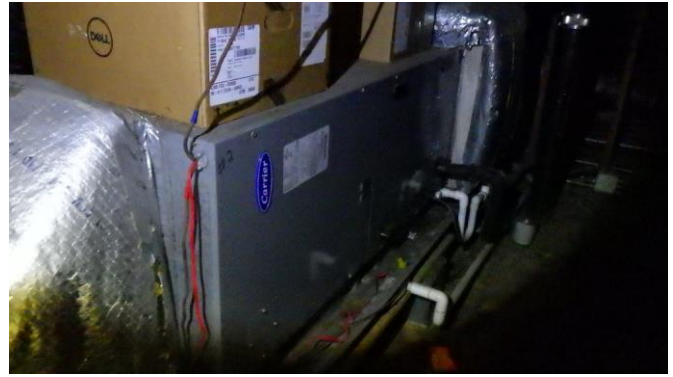
119007e 1/26/2023 Indoor fan unit 2 Attic space
