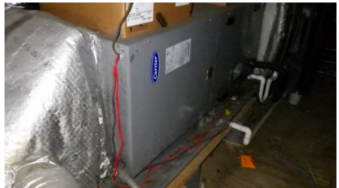
119008e 1/26/2023 Indoor fan unit 1 Attic
