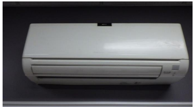
258015e 1/25/2023 Mini split evaporator Office area
