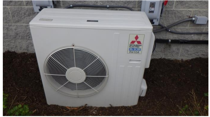
258013e 1/25/2023 Mini split condensing unit Site
