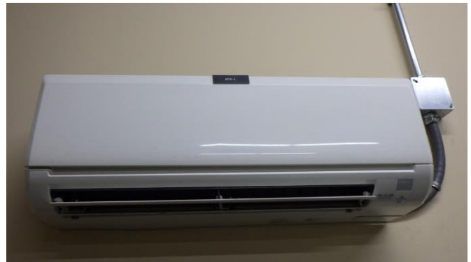
258014e 1/25/2023 Mini split evaporator Office area
