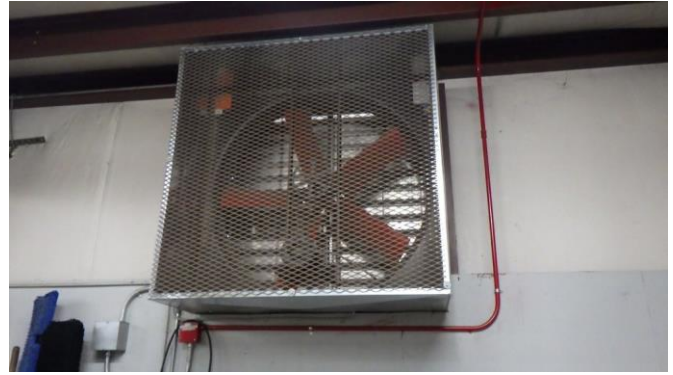
258010e 1/25/2023 Ventilation fan Wash bay
