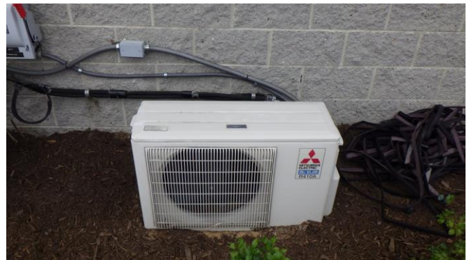
258012e 1/25/2023 Mini split condensing unit Site
