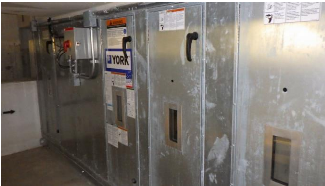
097044e 1/25/2023 Indoor AHU-1 Mechanical 02
