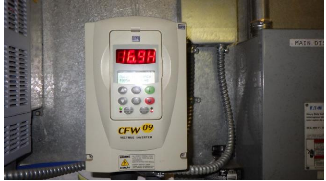
097019e 1/25/2023 AHU-1 return fan #2 VFD Mechanical 334
