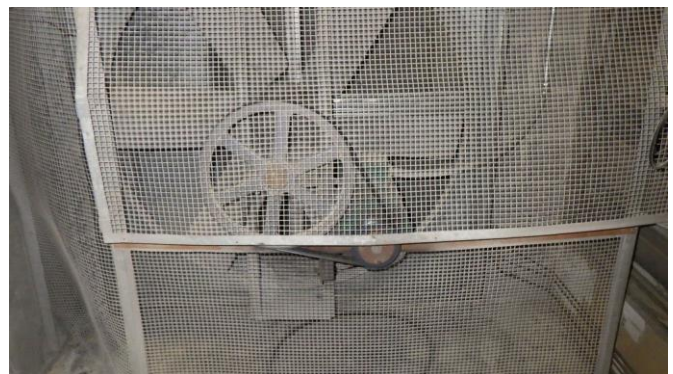
097021e 1/25/2023 AHU-1 return fan #2 Mechanical 334
