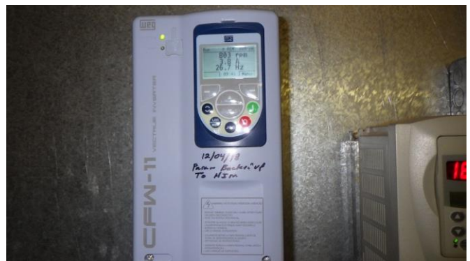
097018e 1/25/2023 AHU-1 return fan #1 VFD Mechanical 334
