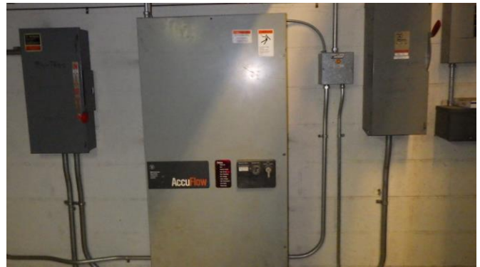
097017e 1/25/2023 AHU-1 supply fan VFD Mechanical 334
