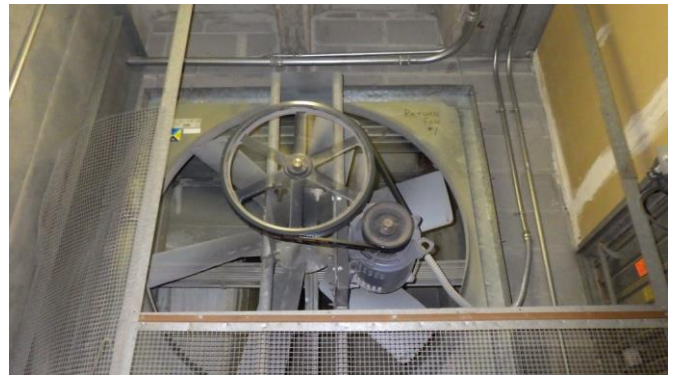
097020e 1/25/2023 AHU-1 return fan #1 Mechanical 334
