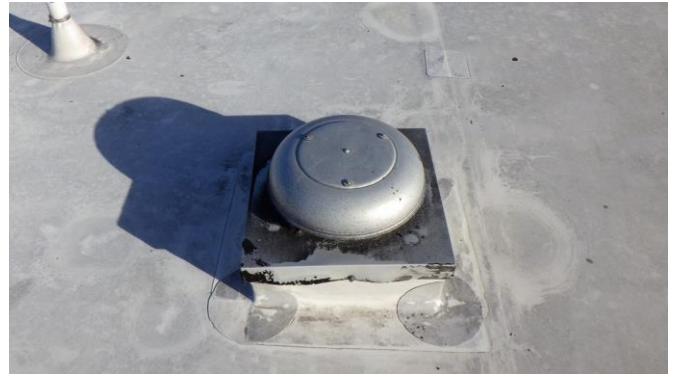
099010e 1/26/2023 Room exhaust fan Main roof
