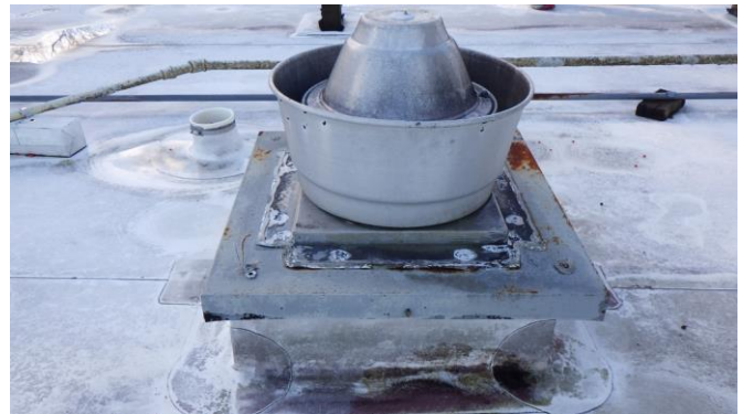
099011e 1/26/2023 Room exhaust fan Main roof
