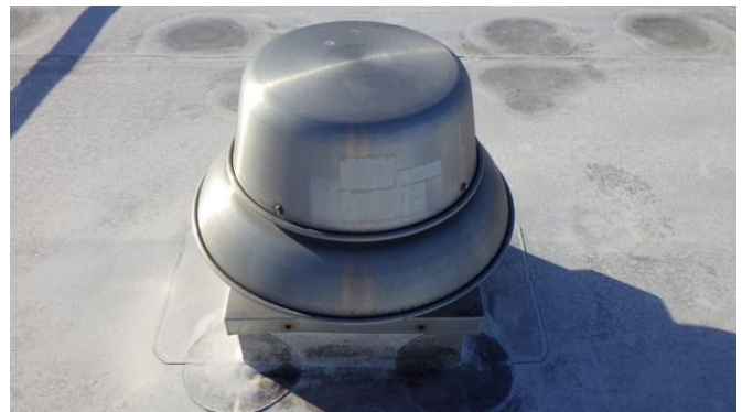
099009e 1/26/2023 Room exhaust fan Main roof
