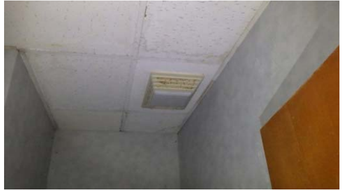
117013e 1/26/2023 Exhaust fan Bathroom
