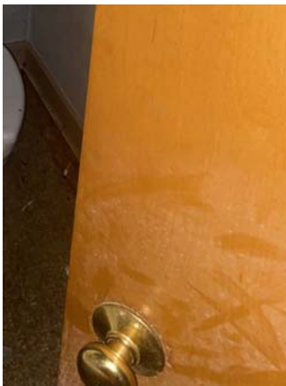
117009a 1/26/2023 Noncompliant knob hardware Office door
